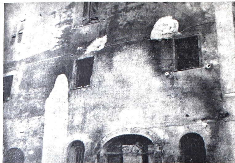
La facciata annerita dello stabile dopo l'incendio (Foto Catenacci)
